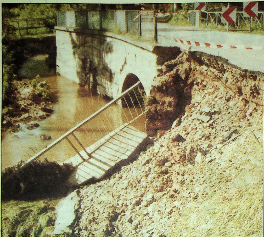
Zniszczony podczas ostatniej powodzi most w Proboszczowie.
