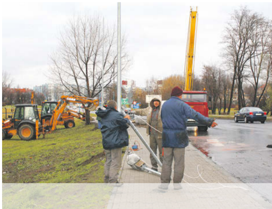
Remontowany był półkilometrowy odcinek Paderewskiego od skrzyżowania z ulicą Wrocławską do skrzyżowania z drogą krajową nr 3
