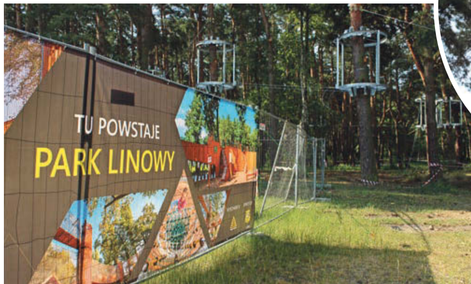
Na drzewach w parku Leśnym właśnie montowane są metalowe konstrukcje, które będą stanowiły domki-bazy
