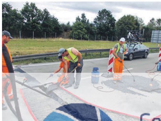
Na jezdni autostrady A4 w kierunku granicy uszkodzeniu uległo kilka płyt betonowych
