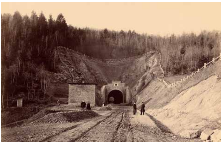
Źródło: Architekturmuseum Technische Universität w Berlinie. Rycina 4. Stopowy, dwutorowy tunel w Bobrowie w ostatniej fazie budowy ok. 1866 r. z pracownikami zatrudnionymi przy budowie oraz prowizorycznym biurem budowlanym
