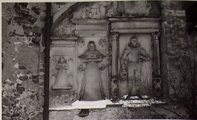
Epitafium na kościelnym murze wymagają pilnej renowacji
